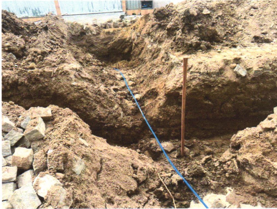
Foto 05 - ESCAVAÇÃO MECANIZADA ATÉ 1,50M EM MATERIAL DE 1º CATEGORIA PARA ABERTURA DE CORTE PARA ATERRO, SEM BOTA FORA
